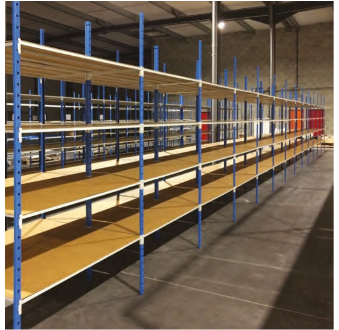
Installations de rangements en longueur sur plusieurs rangées pour le stockage de cartons volumineux de faible charge (Poitou Rayonnage)
